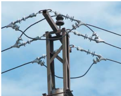
Рис 4. Опора воздушной ЛЭП 10 кВ с изолированными проводниками (кабель) безопасна для птиц.
