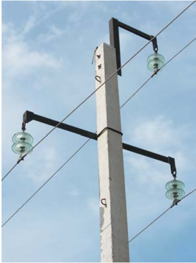
Рис 3. Современная опора воздушной ЛЭП 10кВ с подвесными изоляторами безопасна для птиц.
